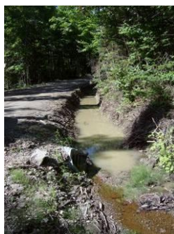
Pt 81: Entretien inadéquat des fossés
