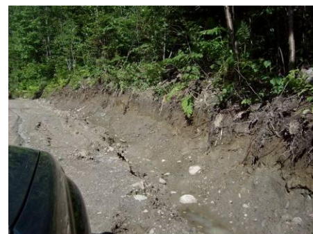
Pt 84: Érosion des fossés
