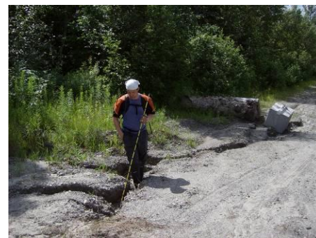
Pt 78: Ravinement de la route
