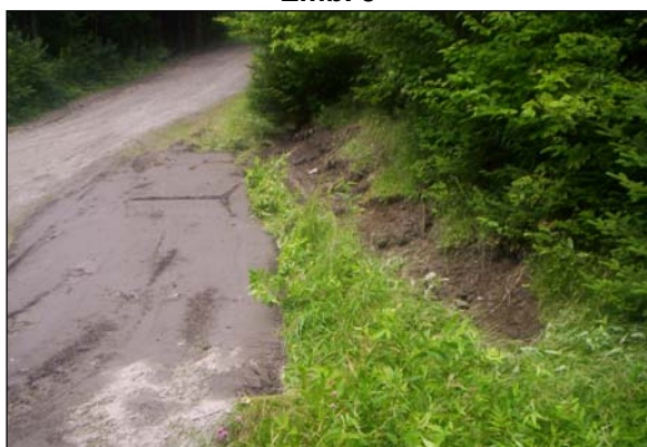
H : Fossé à nu et accumulation de sédiments sur la route (point 23)
