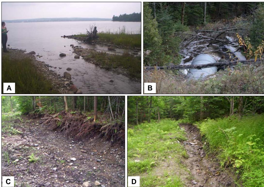
A : Embouchure (point 79) B : Ponceau surélevé (point 80) C : Érosion du chemin forestier (point 81) D : Fossé de drainage érodé (point 82)
